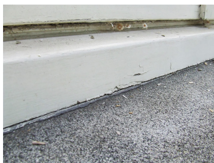
De ruimte tussen raamdorpelsteen en onderdorpel is afgekit.
