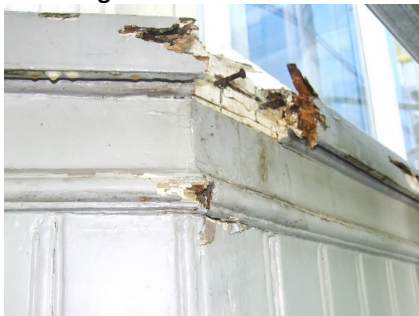
Vervangen gezien de omvang van de aantasting
