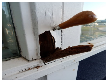
In het verleden heeft men wat gaten gedicht met kit, hierbij heeft men echter verzuimd de achtergebleven hout schade weg te nemen
