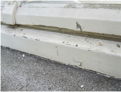
Lichte scheurvorming + scherpe kanten
