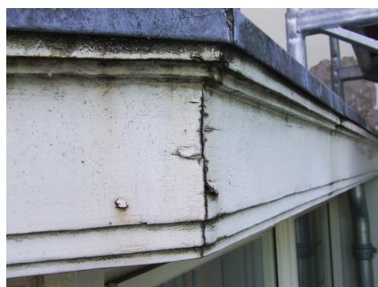
Verbinding daklijst staat open
