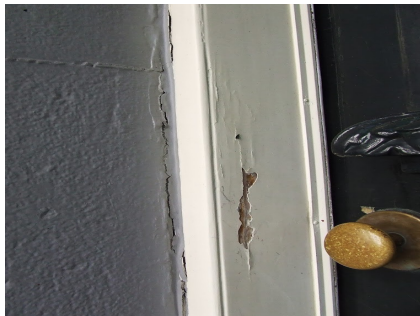
Neggezijde worden geadviseerd open te houden, dit i.v.m. het ventileren van het kozijn
